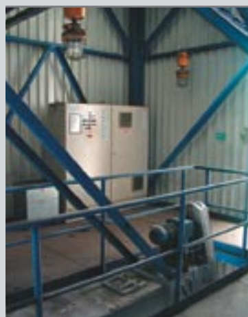
Pohled na řídicí jednotku nakladače v hale alternativních paliv
